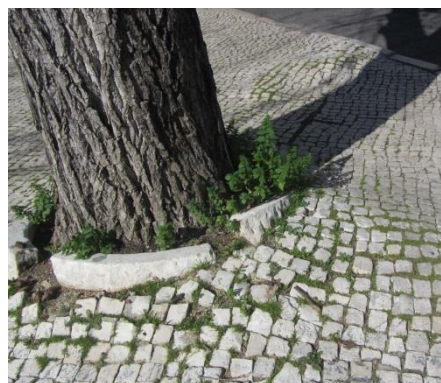
Fig. 3 – Raízes superficiais a danificar a calçada.
